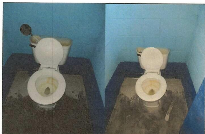
Foto 4: Se realizará cambio de tazas sanitarias, debido a que se encuentran en malas condiciones.
